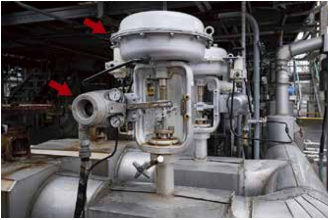
รูปที่ 2 คอนโทรลวาล์วและสแมร์ทไฟซิชันเนอร์ รุ่น AVP700 ที่ใช้ในการควบคุมปริมาณไอน้ำที่ส่งเข้าเตาหลอม เพื่อควบคุมการหลอมละลายของวัสดุ (Raw material)
